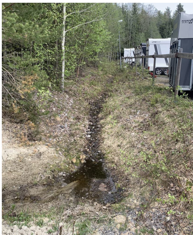
Figur 16. Dike som rinner genom anläggningen. Dagvattenbrunn i kröken som ansluter till bef. ledningsnät. (Tyréns Sverige AB, 2023)
